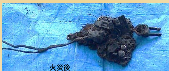
岳北消防本部管内で実際に発生した火災の写真 焼けてしまったテーブルタップと、ヒーターのコンセント
