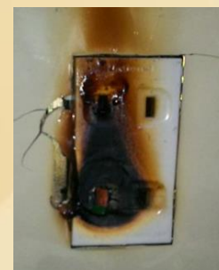
電気容量を超えて発火し、焼けてしまったコンセント
