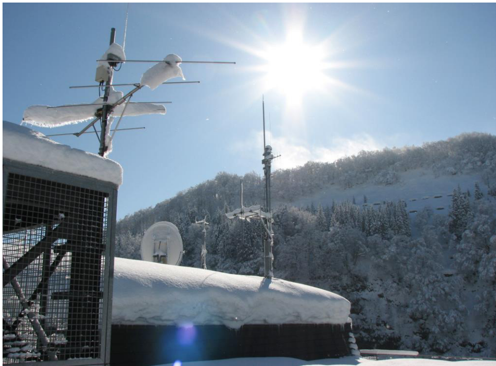
栄村役場屋上 気象観測装置
